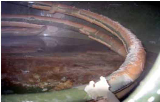
Verschlammter Speicherboden mit verkalkter Heizschlange.
