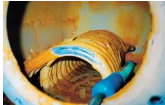
Verschmutzter Speicher mit Legionellen-Kontamination.
